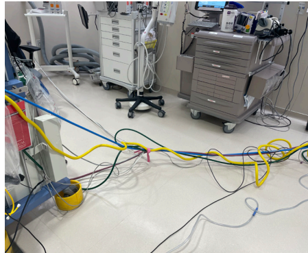
図1: ガス管、データケーブル、電源コード、麻酔器からの吸引チューブは、つまずきの危険を引き起こす。
